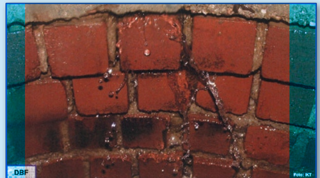
Undichtheit bei Schächten
